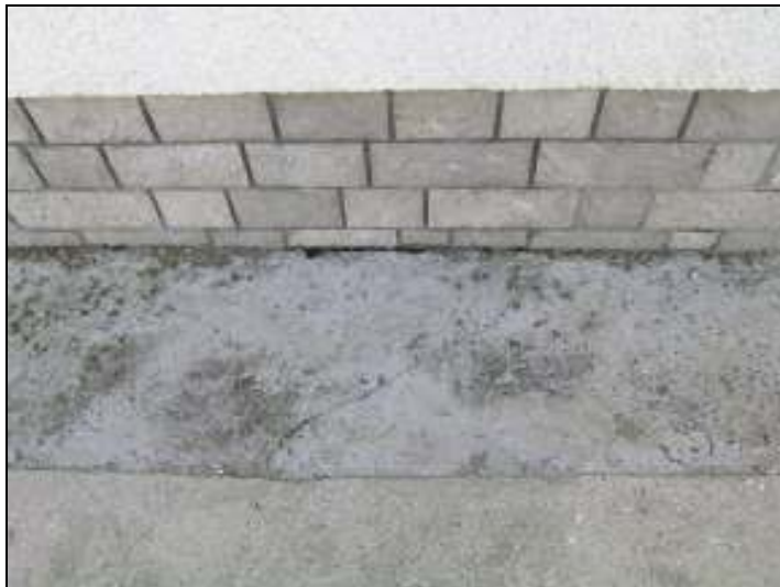
Slika E – 2: Razpoka na obhišnem pločniku
