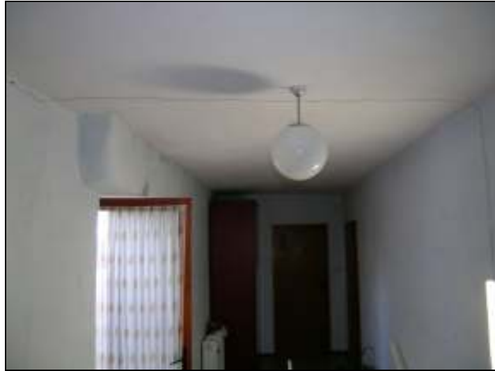
Slika D – 9: Razpoka znotraj objekta
