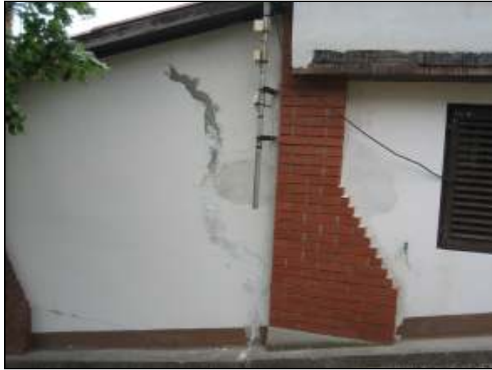
Slika E – 7: (Zacementirana) razpoka na objektu
