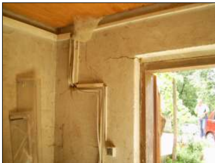
Slika F – 4: Razpoke znotraj obhišnega gospodarskega objekta
