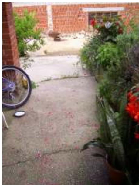
Slika F – 3: Razpoke na obhišnem pločniku
