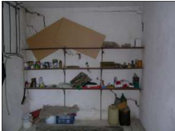
Slika D – 10: Velika razpoka po sredini stene znotraj objekta
