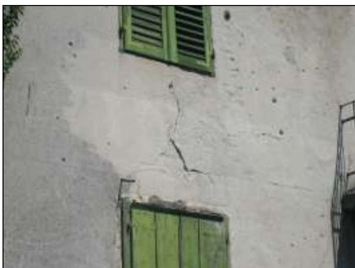
Slika D – 12: Razpoke na objektu
