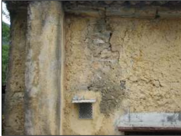
Slika E – 5: Razpoka na objektu
