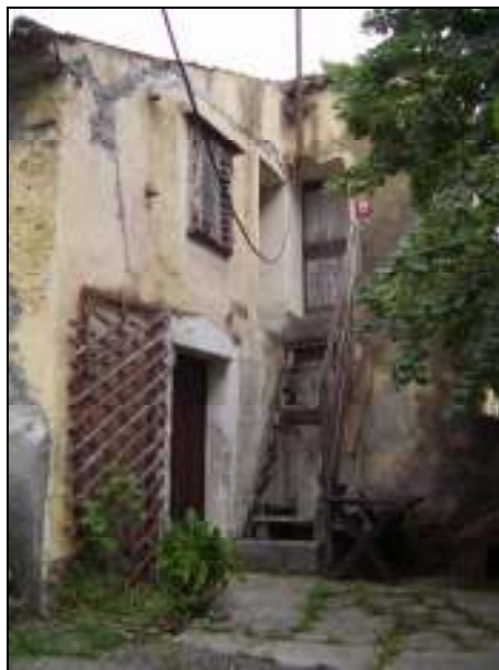
Slika E – 4: Sprednji del objekta z veliko razpoko nad oknom
