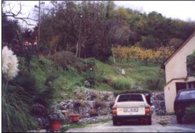
Slika B – 2: Gabioni (Šempeter pri Gorici)
