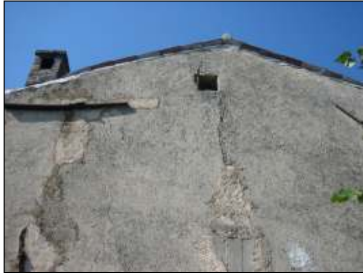
Slika E – 3: Razpoke na obhišnem objektu
