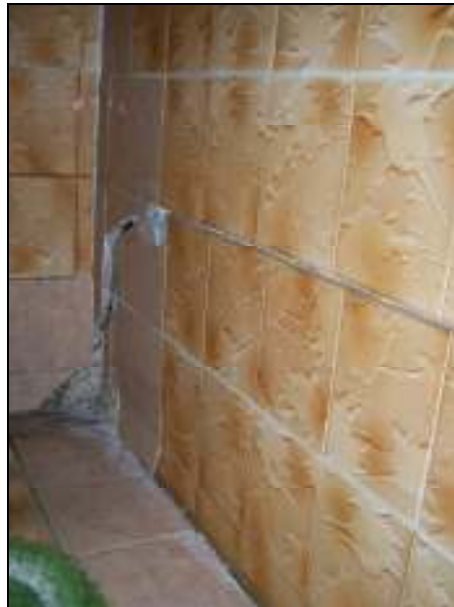
Slika E – 8: Razpoka znotraj objekta
