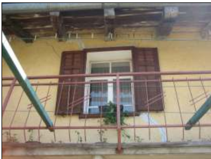
Slika E – 10: Razpoke na objektu
