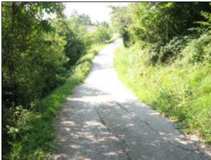
Slika G – 1: Razpoke na cesti – posledica počasnega zemeljskega plazenja med kmetijama Furlan in Kobal
