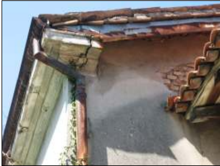
Slika D – 13: Razpoke na objektu
