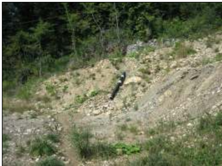
Slika 22: Neurejena odvodnja – drenažna cev ni izpeljana do potoka
