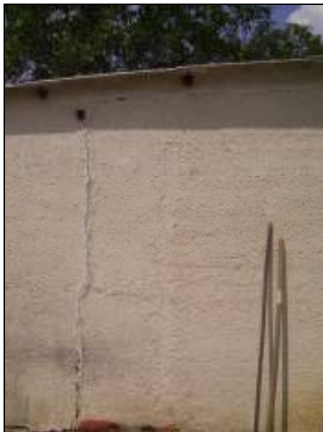
Slika F – 1: Razpoke na obišnem gospodarskem objektu
