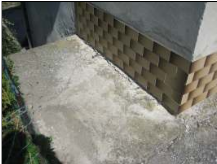
Slika D – 6: Razpoka na obhišnem pločniku
