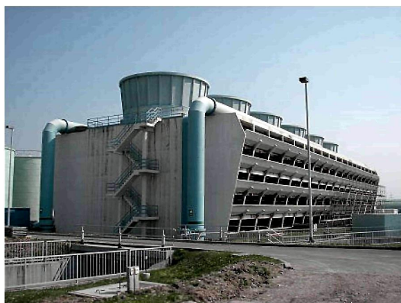
Slika 10: Pogled na hladilne celice s šestimi ventilatorji v NEK (www.nek.si, 15.1. 2009)
