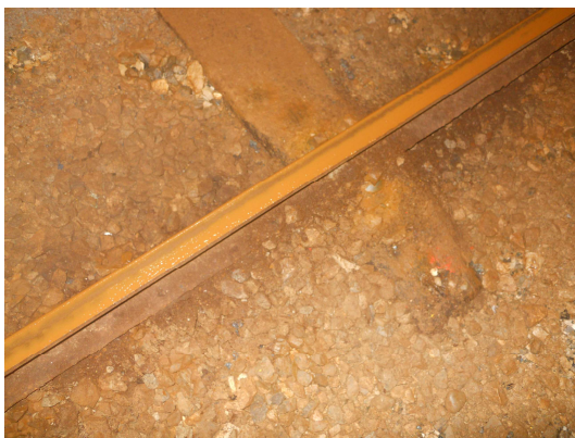
Slika 1: Obraba železniške proge in korozija
