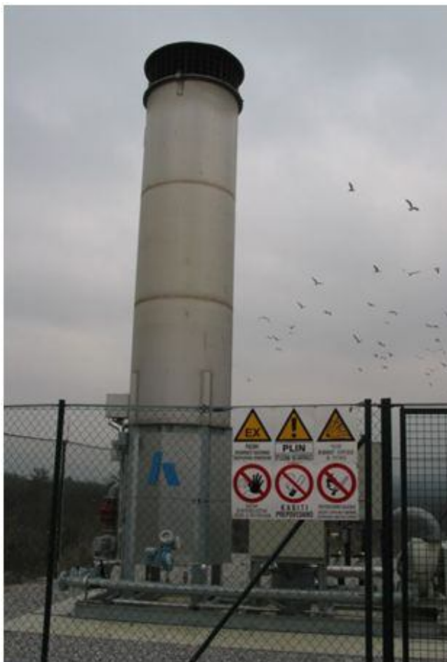
Slika 5: Zgorevanje deponijskega plina (bakla) v CERO Nova Gorica
