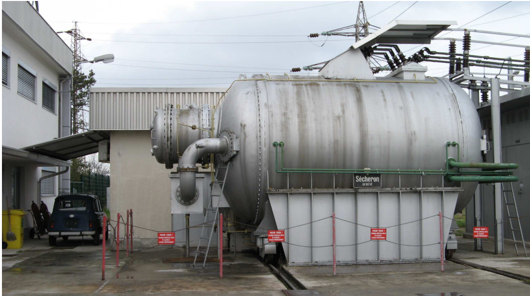
Slika 10: Ohišje sinhronskega kompenzatorja
