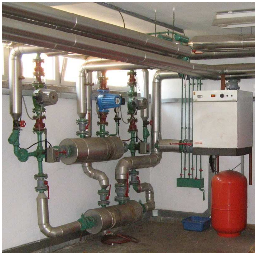
Slika 2: Kotlovnica obstoječega ogrevalnega sistema RTP Divača
