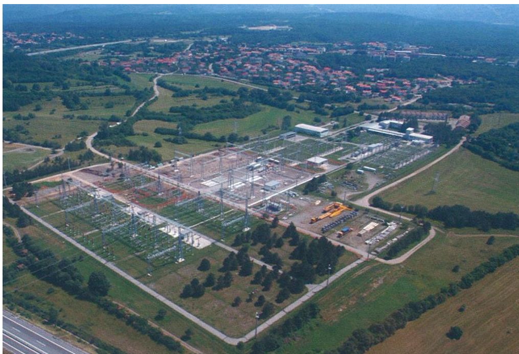
Slika 2: Razdelilna transformatorska postaja Divača (Arhiv, 2010)
