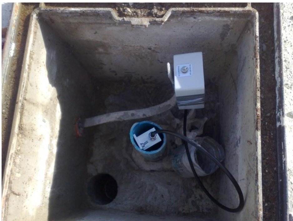
Slika 4: Piezometer, opremljen s sondo za meritev nivojev podzemne vode
