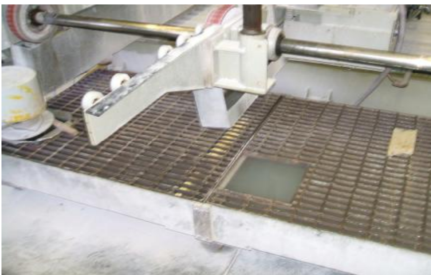
Slika 6-11: Zbiralni bazen s čisto vodo
