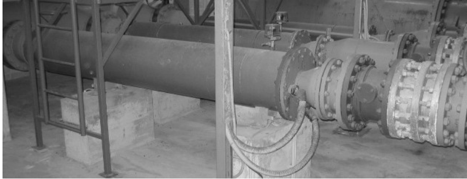
Slika 10 – Črpalni agregati (Rižanski vodovod Koper)
