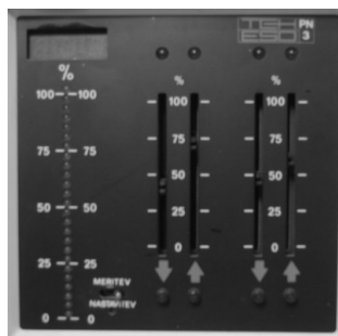
Slika 12 – Regulator (Rižanski vodovod Koper, 2006)
