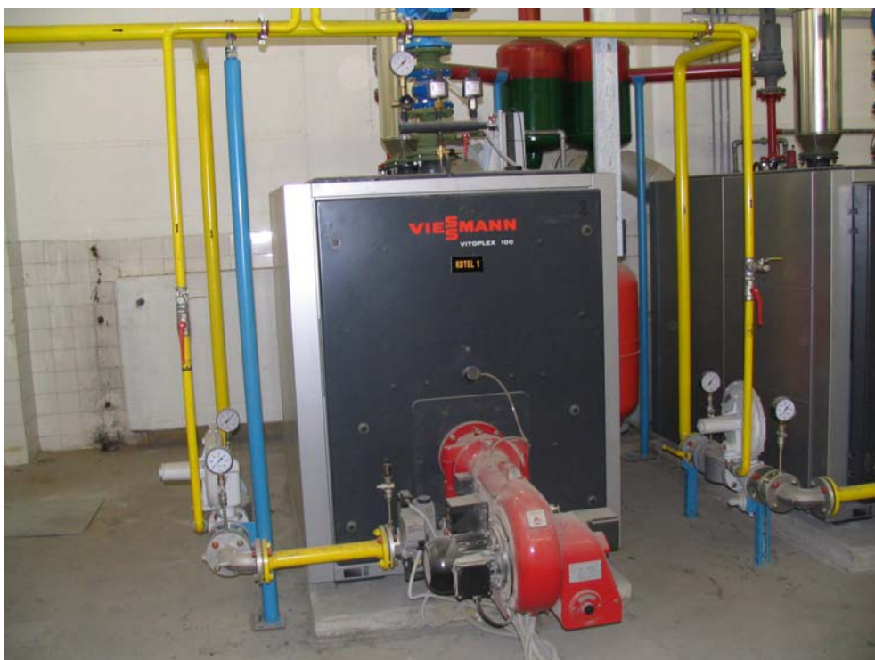
Slika 9: Vgrajen kotel VITOGAS 100 v kotlovnici na severnem delu podjetja Salonit Anhovo, d. d. 12
