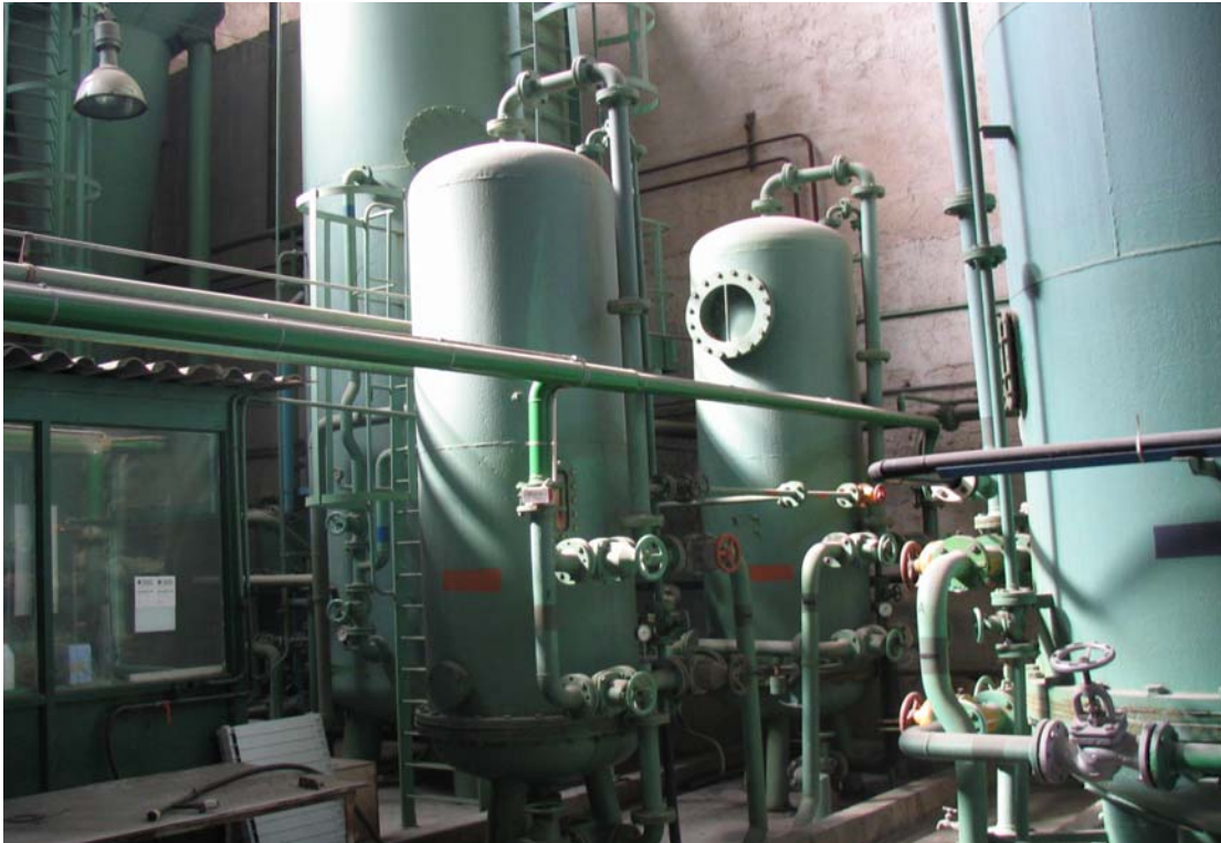
Slika 4: Naprave za pripravo kotlovne vode v obstoječi kotlarni 12
