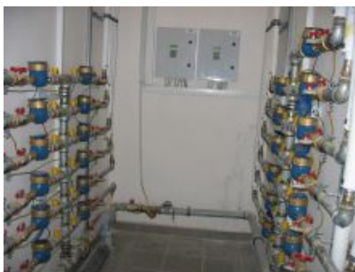
Slika 12: Vodomeri v večstanovanjskih objektih
