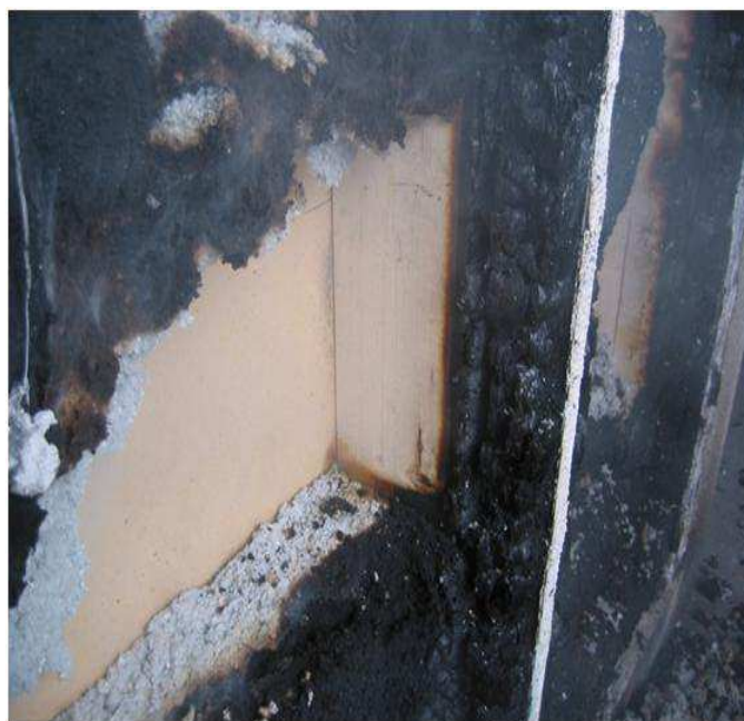
Slika 7: Prikaz požara v stavbi s celulozno izolacijo (Ekoprodukt, 2014)
