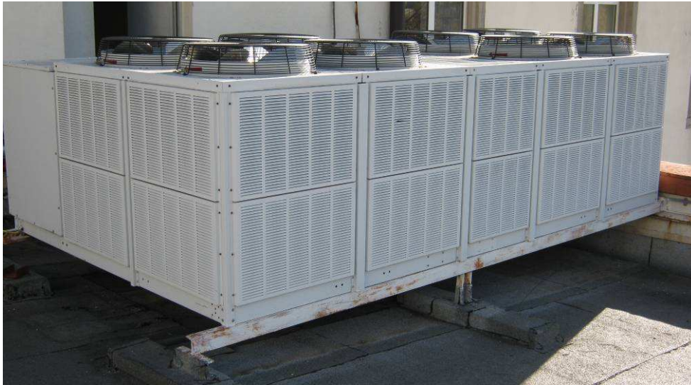
Slika 28: Obstoječi kompresorski hladilni agregat
