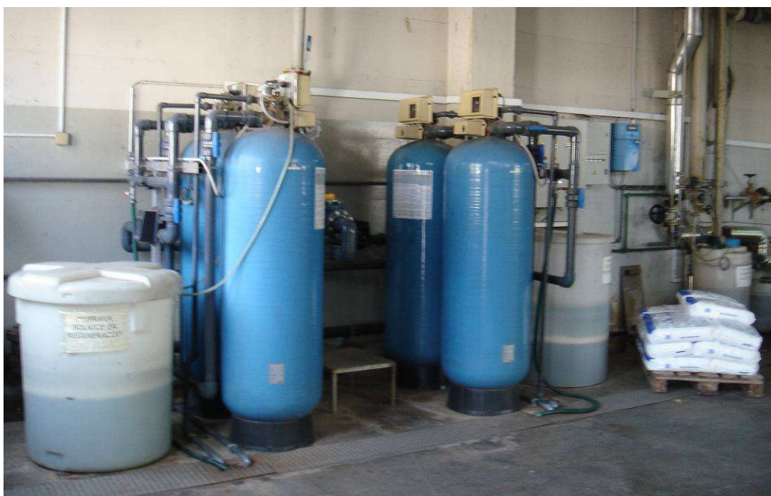
Slika 14: Priprava mehčane vode
