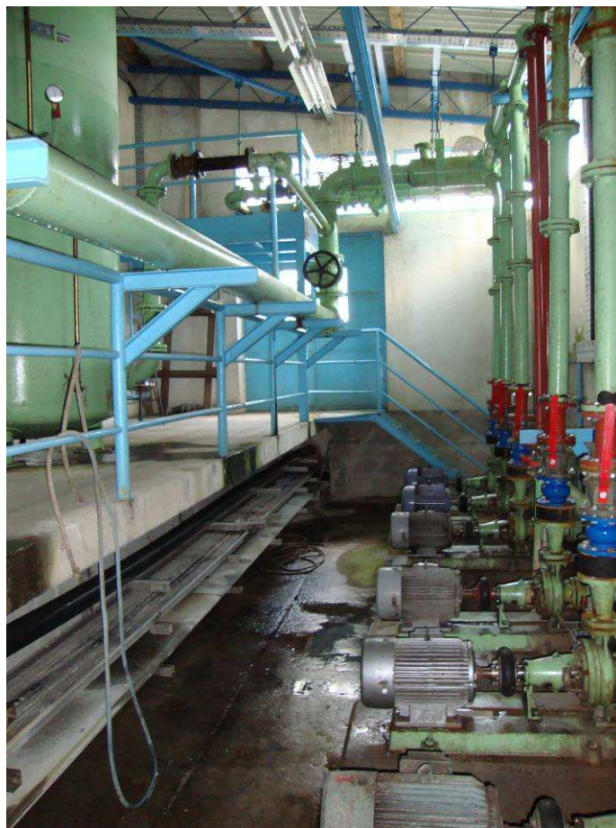
Slika 18: Črpališče hladilne vode
