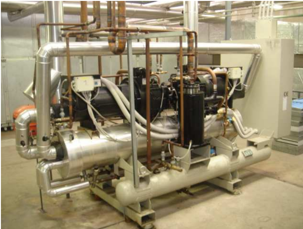
Slika 24: Frekvenčno reguliran vijračni hladilni agregat s hladilno močjo 633 kW
