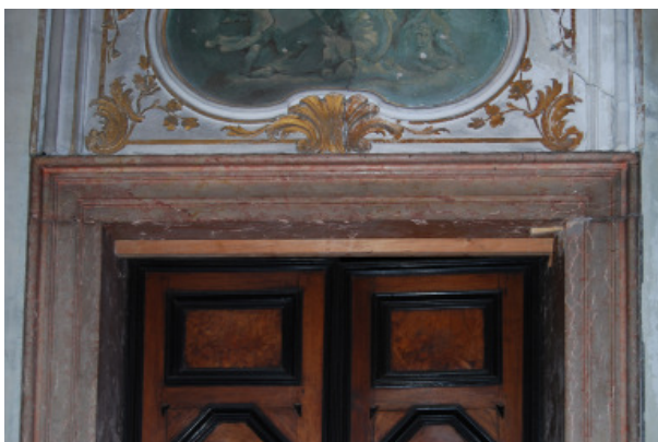
Image 88: Door jamb detached
