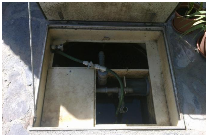
Slika 48: Biološka hišna čistilna naprava locirana v Rubijah na Krasu
